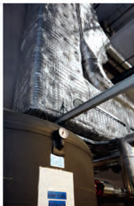
Inuti ståltrådsburen i M2:s garage kan man se en av tre ackumulatortankar och ventilationen för restaurangen i fastigheten.
