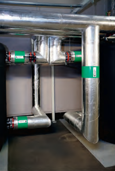
Multifunktionsaggregaten från Clivet har sex rör ut och in. Principen är att maskinen laddar stora ackumulatortankar för varmvatten respektive kallvatten tills de nått sin maxtemperatur. När de inte kan ta emot mer laddas en tank för återvinning.
